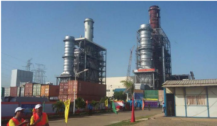
SUNON-ASOGLI POWER PLANT
